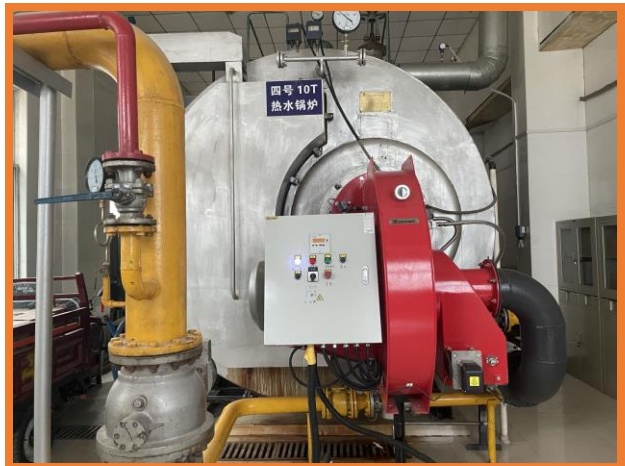
4#锅炉改造燃烧机后
