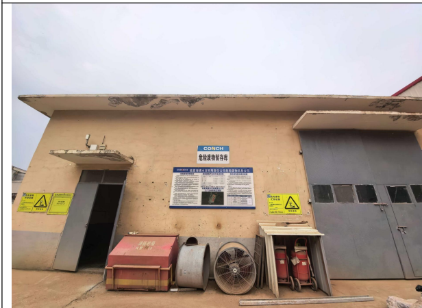
配备的消防器材
